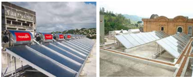
Figs. 14 Instalações de aquecedores solares sobre lajes impermeabilizadas em Israel e no Brasil
