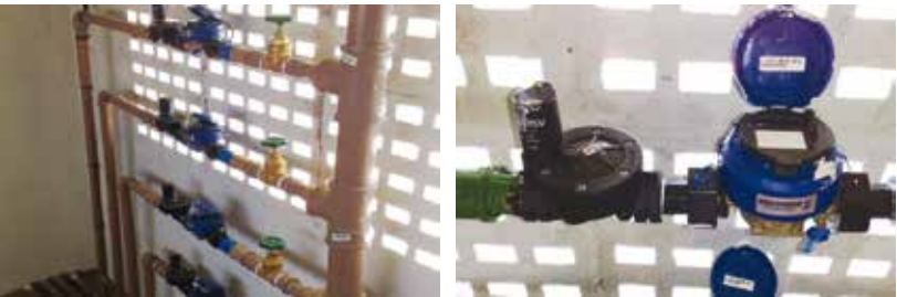
Figs. 10 Instalação de hidrômetros em instalações com medição individualizada de água
