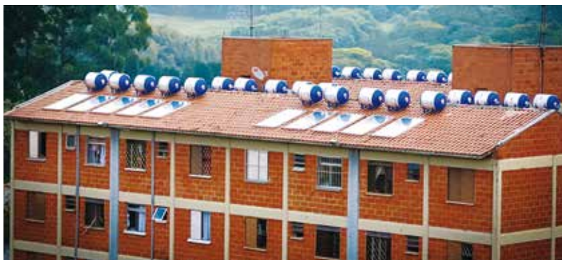
Fig. 36 Sistema de Aquecimento Solar para HIS no CDHU Cidade Tiradentes/ SP
