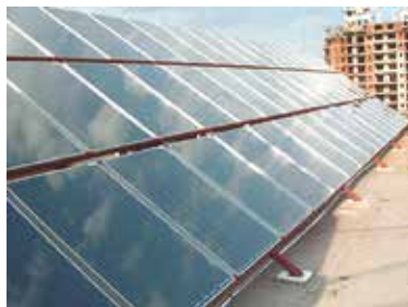
Fig. 33, esquerda Suporte para Coletores EAGoz da OCV – Solar Térmica
